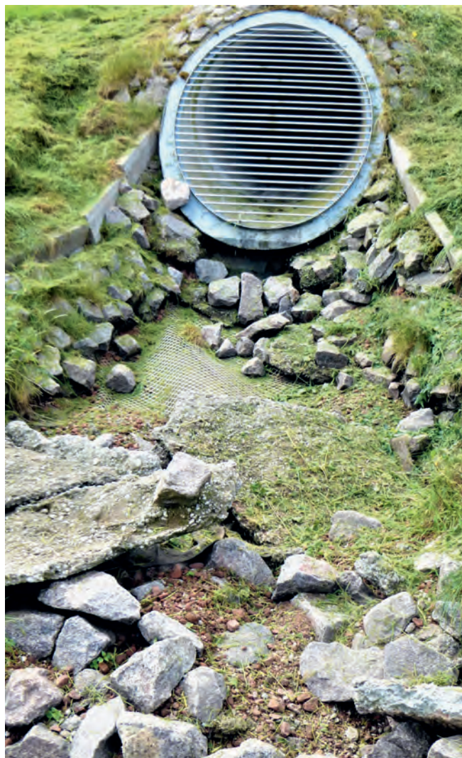
Abbildung 21: Schäden im Auslaufbereich des Regenüberlaufbeckens Figure 21 : Dommages dans la zone d'écoulement du bassin à débordement
