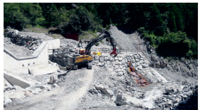
Abbildung 4: Errichtung der Grabsteinschichtung in Beton verlegt im Juli 2020. Wenige Tage nach der Errichtung färbt das Heilwasser die verlegten Steine bereits braun.
