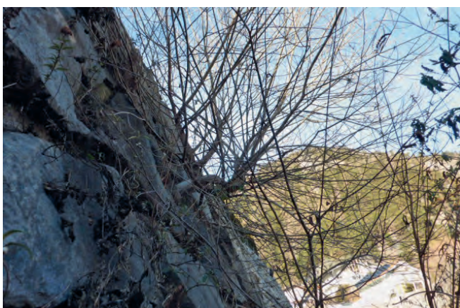
Abbildung 3: Grösste angewachsene Weide. Der Haupttrieb hat die Stärke des Betonrohres. Hier sollte ein Pflegeschnitt durchgeführt werden. Foto Winter 2023.
