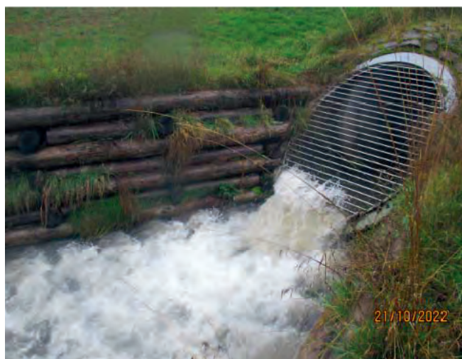
Abbildung 26: Regenrückhaltebecken im Betrieb Figure 26 : Bassin de rétention des eaux pluviales en service
