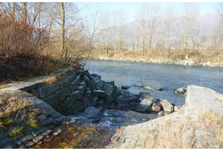
Fig. 2: Salto di fondo artificiale alla confluenza del Trodo nel fiume Ticino; sponde e alveo artificiali sul piano golenale del fiume Ticino. Fig. 2 : Ressaut du lit artificiel au confluent du Trodo et du Tessin ; berges et lit artificiels sur le plan alluvial du Tessin. Abb. 2: Künstliches Flussbett am Zusammenfluss von Trodo und Ticino; künstliche Ufer und Flussbett auf der Schwemmebene des Ticino.
