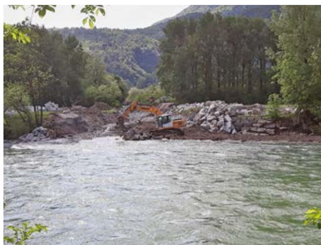
Fig. 8: Demolizione degli argini presso la confluenza con il fiume Ticino. Fig. 8 : Démolition des remblais à la confluence avec le Tessin. Abb. 8: Abbruch der Aufschüttungen bei der Einmündung in den Ticino.
