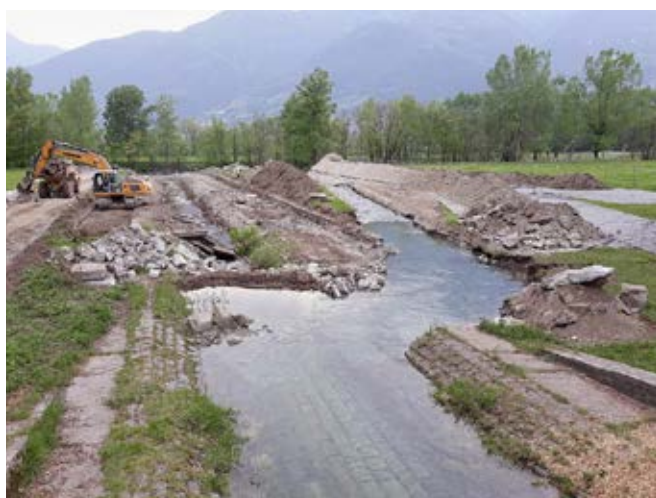
Fig. 9: Deviazione temporanea delle acque per le attività di demolizione e allargamento della foce. Fig. 9 : Déviation temporaire du cours d'eau pour les activités de démolition et d'élargissement de la confluence. Abb. 9: Vorübergehende Umleitung des Flusses für Abbruch- und Aufweitungsarbeiten am Einmündungsbereich.
