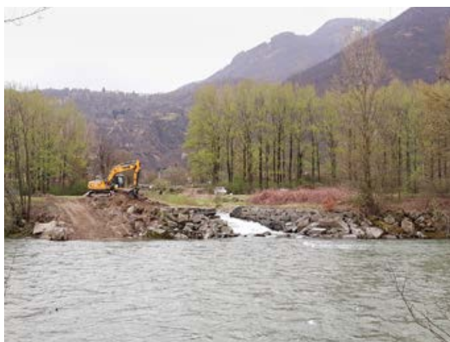
Fig. 7: Situazione dopo la demolizione del salto di fondo e scavi in zona confluenza con il fiume Ticino. Fig. 7 : Situation après la démolition du ressaut du lit et l'excavation à la confluence avec le Tessin. Abb. 7: Situation nach dem Abriss des Sohlvorsprungs und dem Aushub am Zusammenfluss mit dem Ticino.
