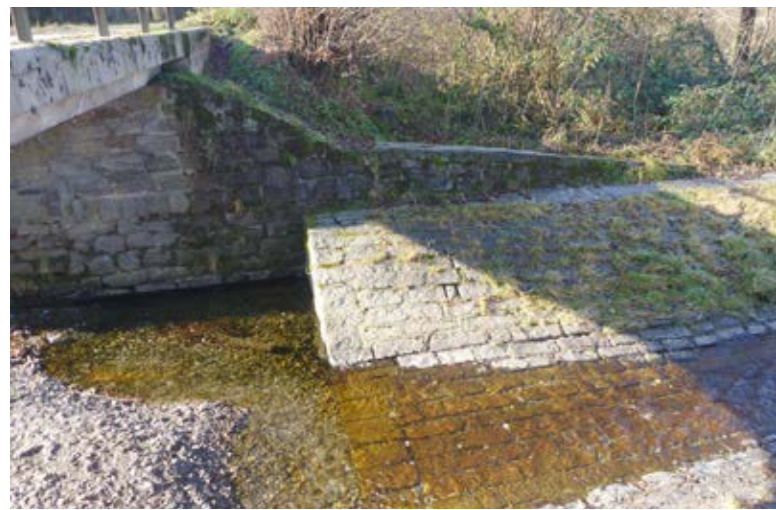
Fig. 3: Soglia in massi cementati che delimita la vasca di ritenuta presso l'argine insommergibile e il ponticello carrabile. Fig. 3 : Seuil en blocs cimentés délimitant le bassin de rétention au niveau du talus non submersible et du pont-véhicule. Abb. 3: Schwelle aus Zementblöcken, die das Rückhaltebecken an der nicht überflutbaren Böschung und der Fahrzeugbrücke begrenzt.
