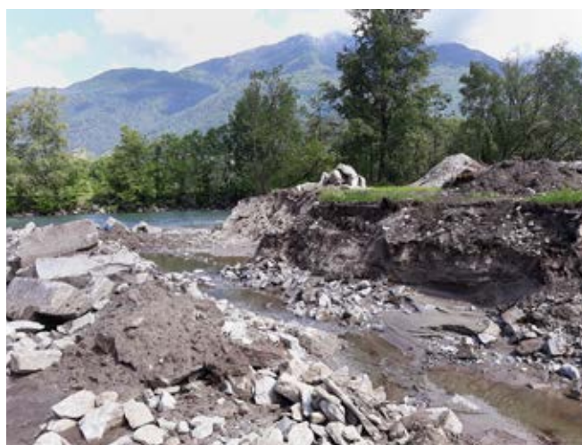
Fig. 10: Scavi per il rimodellamento e l'ampliamento della confluenza dopo la deviazione temporanea della acqua. Fig. 10 : Excavation pour le remodelage et l'élargissement de la confluence après la déviation temporaire du cours d'eau. Abb. 10: Aushubarbeiten zur Rückmodellierung und Vergrößerung des Einmündungsbereichs nach der vorübergehenden Umleitung des Wasserlaufs.
