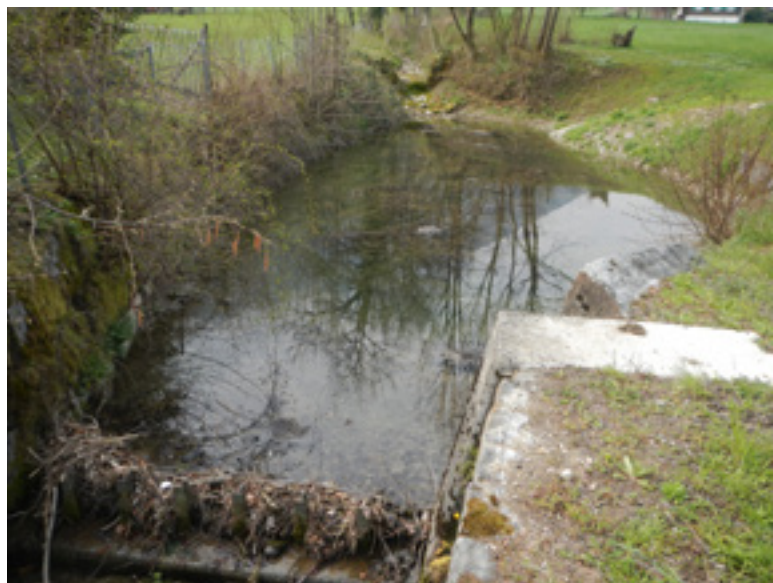
Abbildung 3: unterer Geschiebeablagerungsplatz am Dürrbach. | Figure 3 : Emplacement de dépôt des sédiments en aval sur le Dürrbach.
