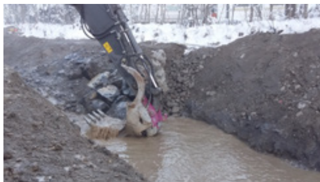
Abbildung 25: Trübung verursacht durch Baustelle. Foto: Fredy Elber, AquaPlus AG. Figure 25 : Turbidité causée par le chantier de construction. Photo : Fredy Elber, AquaPlus AG.
