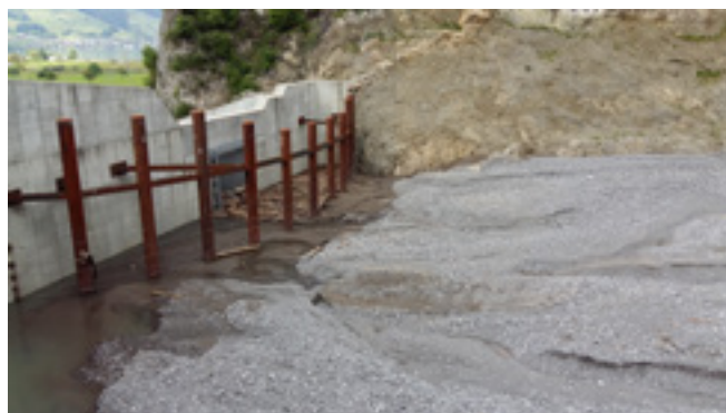
Abbildung 32: Geschiebesammler. Foto: Fredy Elber, AquaPlus AG. Figure 32 : Dépotoir à alluvions. Photo : Fredy Elber, AquaPlus AG.
