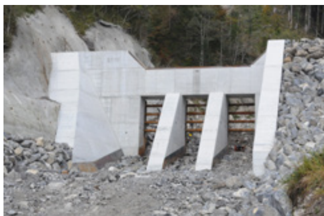
Abbildung 12: Ausleitbauwerk am Glyssibach oben im Modell und unten in Natur. Blick gegen die Fließrichtung. | Figure 12 : Ouvrage de dérivation sur le Glyssibach haute modélisé et en bas dans la nature. Vue dans le sens contraire de l'écoulement.
