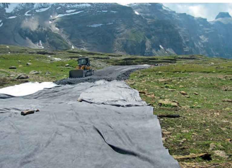
Abbildung 20: Verlegtes Vlies unter der Baupiste vom Mutsee zum Fensterstollen. | Figure 20 : Nappe posée sous la piste de construction du Mutsee à la galerie d'accès.
