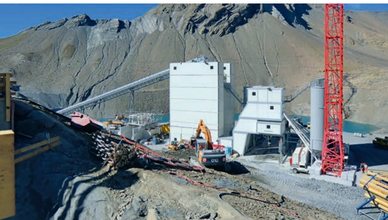
Abbildung 8: Betonwerk Muttsee, welches im zukünftigen Seeperimeter erstellt wurde. | Figure 8 : La centrale de beton du Muttsee, construite dans le futur périmètre du lac.
