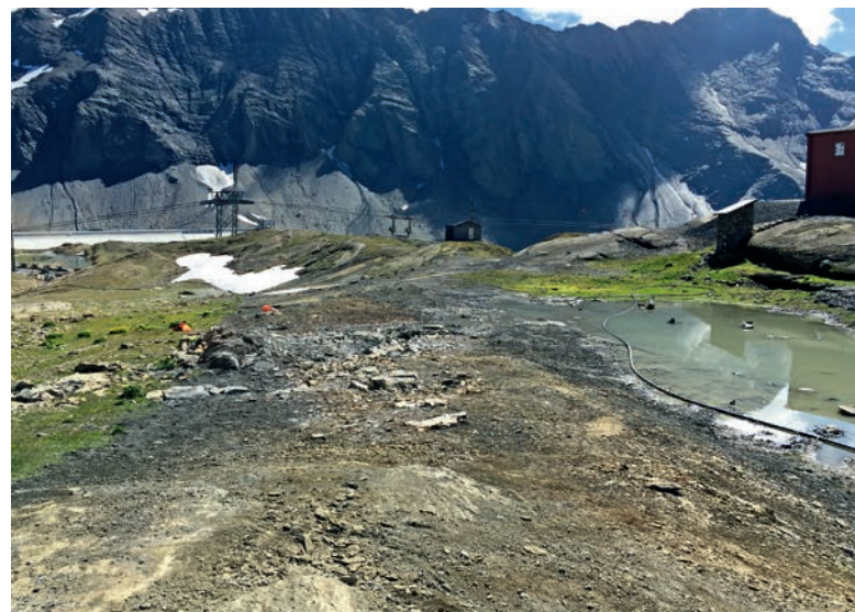
Abbildung 21: Frisch rückgebauter und gesäubert Bereich der Baupiste Fensterstollen – Mutsee bei der Mutseehütte im Jahr 2018. | Figure 21 : Zone fraîchement démontée et nettoyée de la piste de construction galerie d'accès-Mutsee près de la cabane du Mutsee en 2018.
