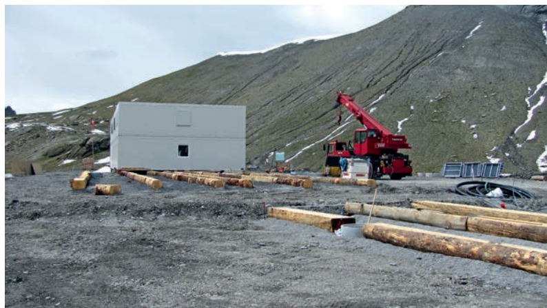
Abbildung 5: Das Camp Muttsee diente rund 200 Bauarbeitern und -innen während der Bauzeit als Unterkunft auf der Baustelle. | Figure 5 : Le camp de Muttsee a servi de logement à environ 200 ouvriers pendant la période de construction.
