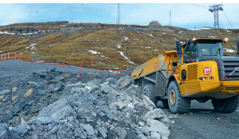
Abbildung 4: Baupiste vom Fensterstallen via Muttseehütte zum Muttsee. | Figure 4 : Piste de construction de la galerie d'accès au lac Muttsee via la cabane de Muttsee.
