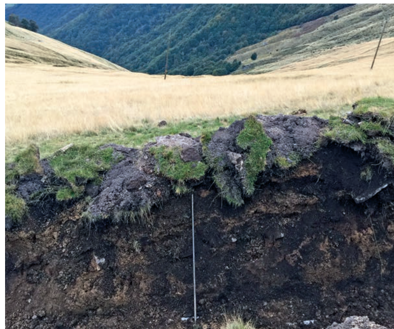
Figura 13: trincea di scavo e separazione delle zolle. | Abbildung 12: Trennung der Ziegel zur Rekultivierung während dem Aushub.
