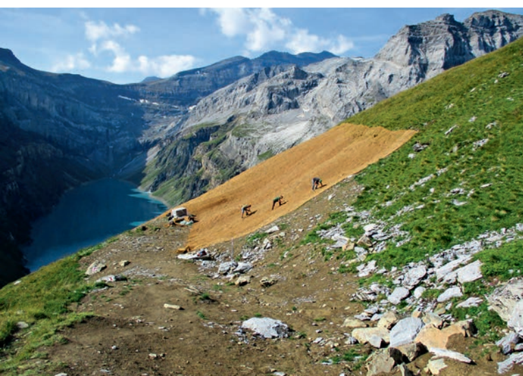
Abbildung 29: Der Bereich der rückgebauten Stütze 2 der Bauseilbahn 2 wurde im August 2018 angesät und bepflanzt. | Figure 29 : La zone du pilier 2 démantelé du téléphérique de chantier 2 a étéensemencée et plantée en août 2018.
