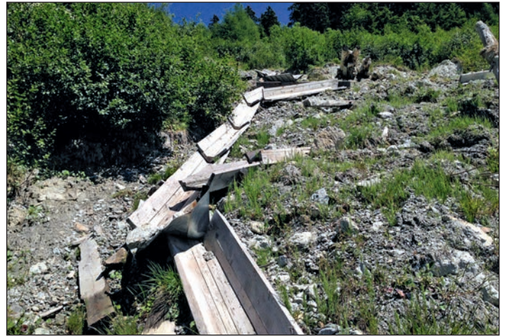
Abbildung 5: Zerstörtes Wasserableitungssystem inkl. Überbrückungskanäle aus Blech. Am rechten Bildrand eine auseinandergesogene Baumfaschine mit einer Verschiebung von über 10 m. Foto Hansjörg Weber, Juli 2014.
