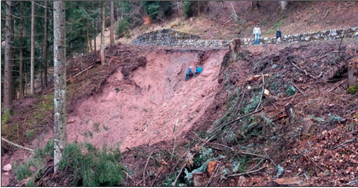
Abbildung 7: Fliessenstrasse: Rutschung im Frühjahr 2016. Die Rutschung reicht bis an den talseitigen Strassenrand und gefährdet die Strasse sowie deren Kunstbauten.
