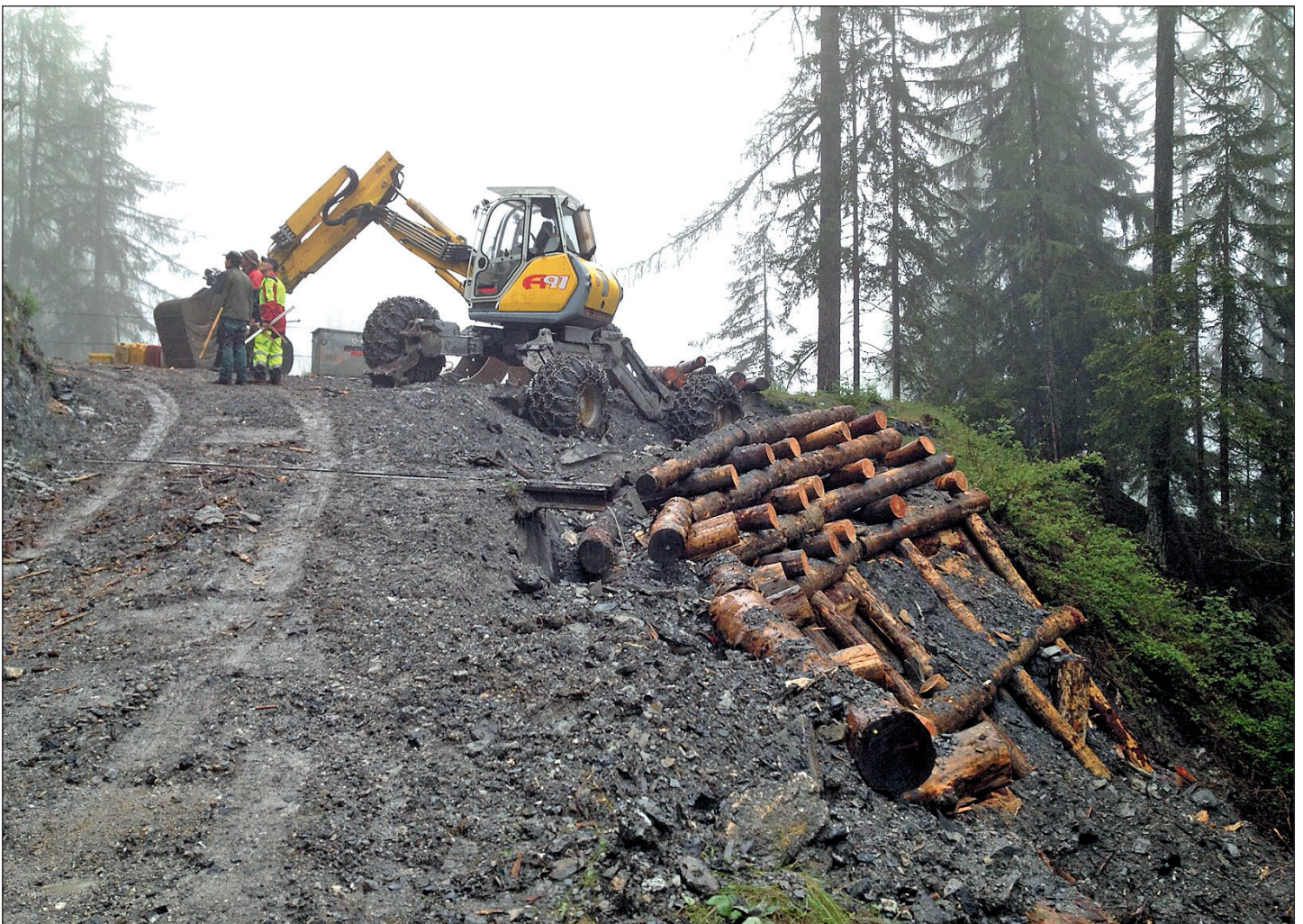
Abbildung 4: Bau eines Hangrostes / Holzkastens im Mutttertobel, Gemeinde Mutten (Foto: C. Bieler). Figure 4: Construction d'un treillage / caisson en bois à Mutttertobel, commune de Mutten (photo: C. Bieler).
