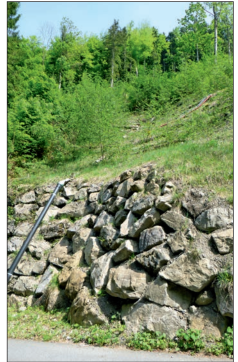
Abbildung 8: Der gesicherte Hang im Bereich des in Abbildung 5 dargestellten Profils (Mai 2017). Figure 8: Le versant sécurisé dans la zone du profil représenté à la figure 5 (mai 2017).
