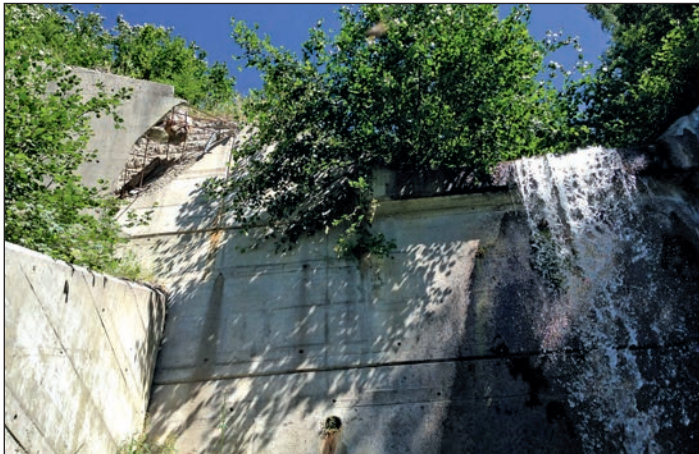
Abbildung 6: Betonsperre mit abgeschertem rechtsseitigen Sperrenflügel. Der Flügel hat sich um mehrere Meter Richtung Bachbett gedreht. Foto Hansjörg Weber, Juli 2014
