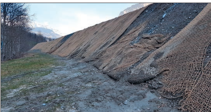
Abbildung 11: Auftragsböschungen mit Jutegewebe gesichert (Ende März 2017). Im Herbst 2016 wurde die Böschung erstellt. Über den Winter verursachte unkontrolliert abfließendes Oberflächenwasser an exponierten Stellen Beschädigungen in der Böschung (Gemeinde Glarus Süd, Linthal: Baustelle im Projekt Linthal 2015 der Kraftwerke Linth-Limmern AG, 8783 Linthal).
