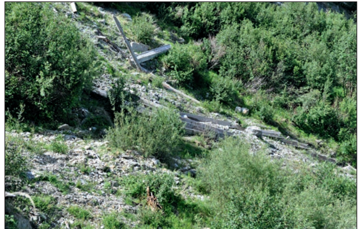
Abbildung 7: Fläche mit Erlendecksaat, Buschlagen und zerstörtem Hangverbau mit Holzkasten und Hangrost sowie Wasserableitungssystem. Foto Jörg Clavadetscher, Juni 2017.
