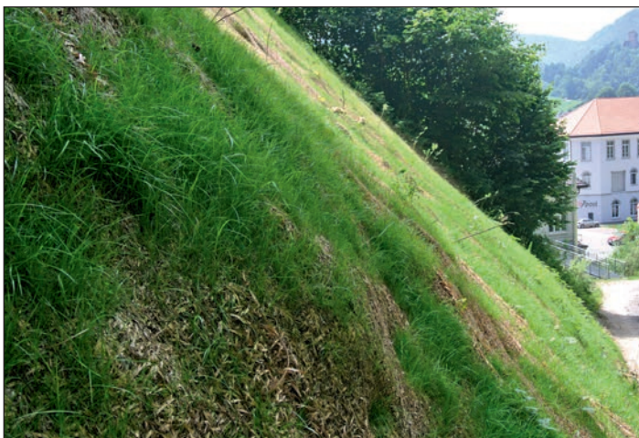
Abbildung 3: Bereits einige Wochen später zeigt sich der Hang im grünen Kleid. Die Holzwollevliese sind kaum mehr sichtbar.
