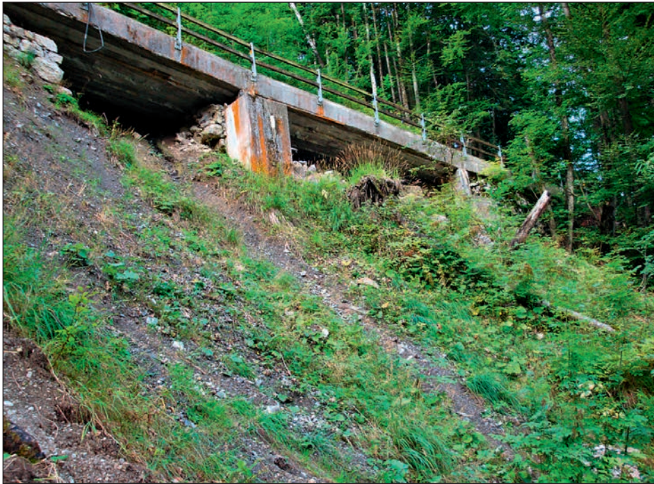
Abbildung 3: Mullernstrasse: Objekt vor Massnahmen. Rückschreitende Erosion und oberflächennahe Rutschungen haben die Fundamente der Stützkonstruktionen der Strasse freigelegt. Figure 3: Mullernstrasse: objet avant les mesures. Une érosion régressive et des glissements de terrain superficiels ont mis à découvert les fondations des structures de soutien de la route.
