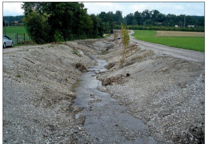
Abb. 3: 23. Juli 2014: Blick in Richtung Bahndamm. Der Schwandbach ist im Rohbau erstellt. Im unteren Teil des Schwandbachs konnte komplett auf eine Ufersicherung verzichtet werden (Sohlengefälle 2 Promille). Sichtbar sind einzelne Wurzelstöcke und Natursteinblöcke (Strukturelemente).
