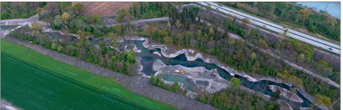
Abb. 7: Luftaufnahme der Verlegungsstrecke während der Bauarbeiten. Neben dem neuen Gerinne sind der ehemalige, bereits teilweise verfüllte Kanal (unten links) sowie der Lärmschutzdamm entlang der Autobahn A1 (oben, rechte Bildhälfte) erkennbar (Quelle: Amt für Wasser und Energie, St.Gallen).
