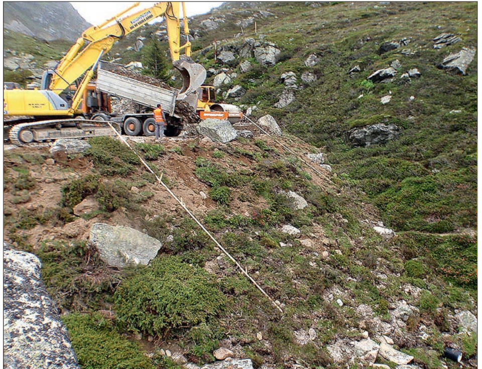
Abb. 1: Direktumlagerung im Untersuchungsgebiet: Vegetationsziegel werden ohne weitere ingenieurbiologische Massnahmen (z.B. Befestigung mit Holznägeln) direkt und stabil zwischen die fest in den Boden eingelagerten Blockschuttfelsen eingebracht (von Albertini 2014).
