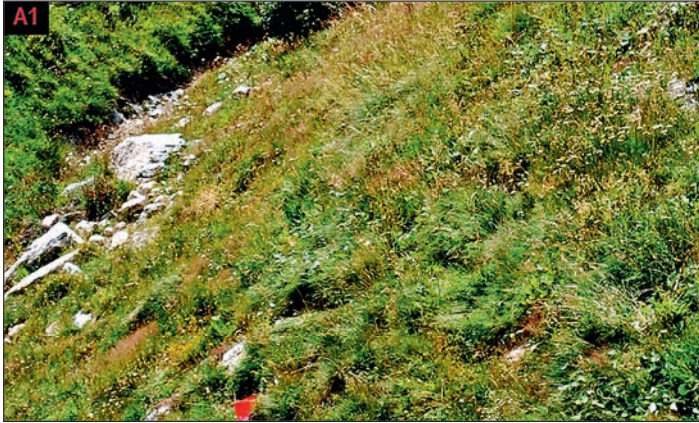
Abb. 10: Die durchschnittlich 45° steile Böschung der Untersuchungsfläche A1 weist einen hohen Vegetationsdeckungsgrad auf. Die Lücken zwischen den Ziegeln sind nur noch schwer erkennbar. Die gewollt naturnahe Gestaltung der Begrünung mit kleinräumig unebener Struktur ist gut erkennbar. Fig. 10: Le talus incliné en moyenne à 45° de la zone d'analyse A1 présente un degré élevé de couverture végétale. Les espaces entre les mottes sont difficilement reconnaissables. L'aménagement proche de la nature de la végétalisation avec une structure irrégulière et à petite échelle est bien perceptible.
