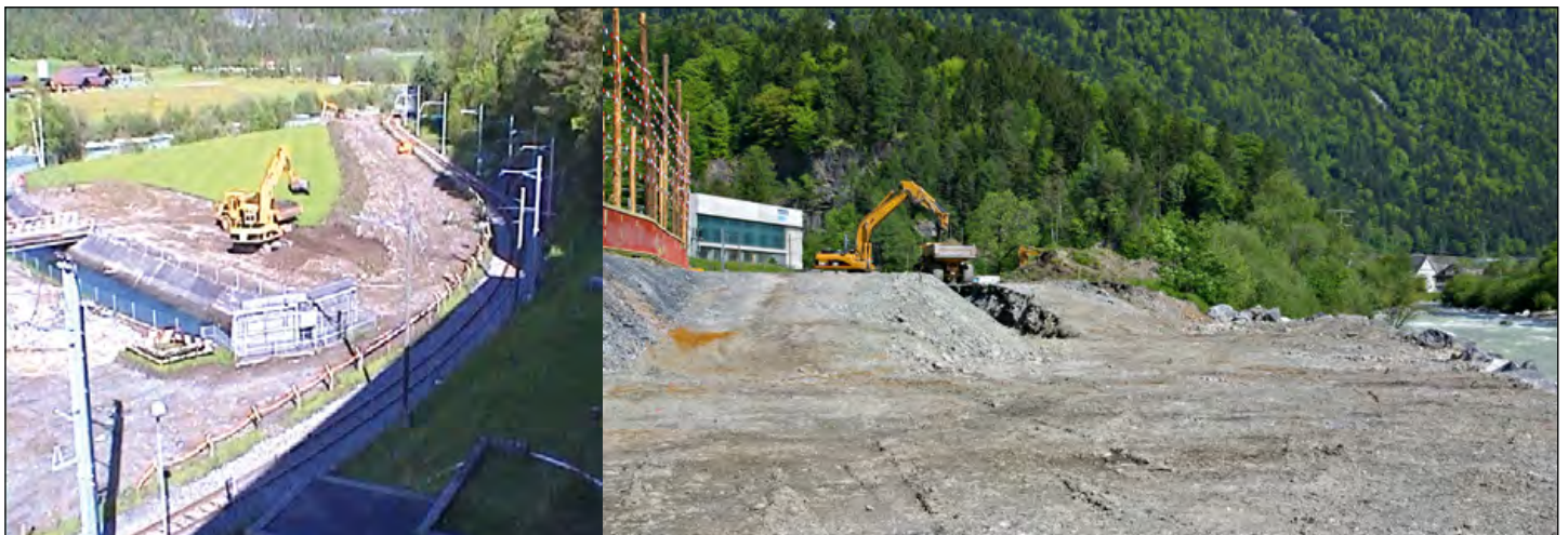
Bild 9a und 9b: Illustrationen zum Beginn der Bauarbeiten am Beruhigungsbecken. Fig. 9a et 9b: Illustrations du début des travaux du bassin d'amortissement.
