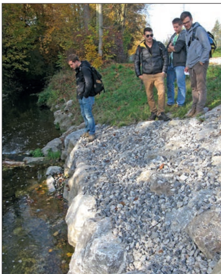
Abb. 2: Schlechtes Unterhaltsbeispiel. Fig. 2: Mauvais exemple d'entretien.
