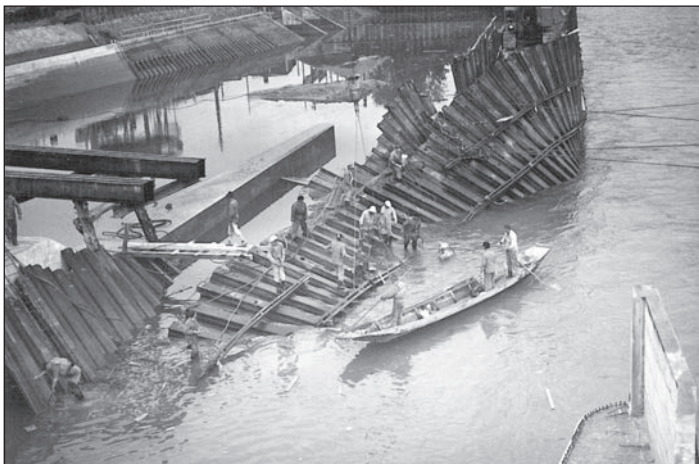
Abb. 5: Einsturz Fangdamm am 19. Mai 1965 (Foto: BKW) Fig. 5: Effondrement de la digue le 19 mai 1965 (photo: BKW)
