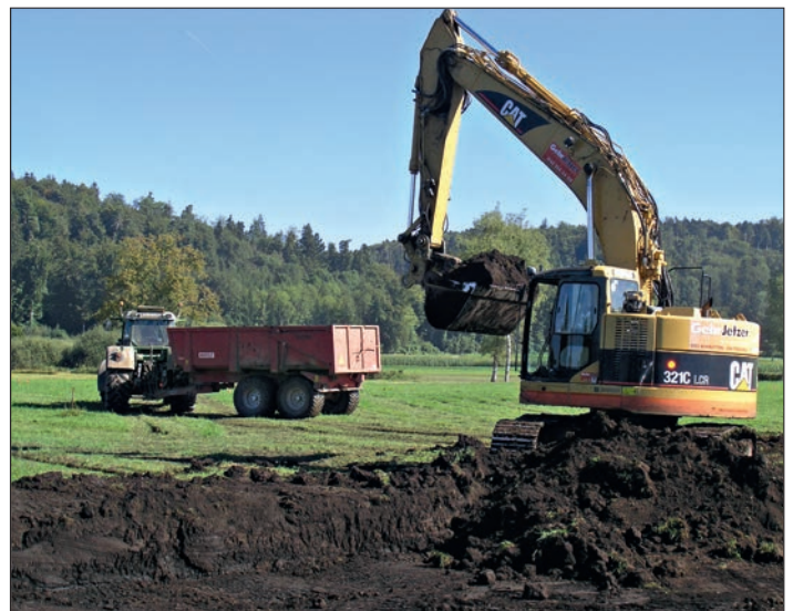
Abb. 2: Abtrag des Torfbodens mit Raupenbagger, September 2013 (Foto: F. Leiser) Fig. 2: Excavation de la tourbière à l'aide d'une pelle mécanique, septembre 2013 (photo: F. Leiser)
