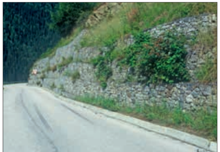
Abb. 17: Böschungssicherung mit Drahtsteinkörben, die durch eine Bepflanzung während des Baues besser in die Landschaft passen würden. Strasse von Burgeis nach Schlinig, Südtirol. Fig. 17: Stabilisation de versant avec des gabions, qui s'adapteraient mieux au paysage durant les travaux s'ils étaient végétalisés. Route de Burgeis à Schlinig, Tyrol de Sud.
