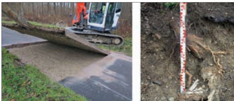
Abb. 7: Untypisches Schadbild: Gehölzwurzel durchwächst die Tragschicht in einer Tiefe von 50 cm. Fig. 7: Dommage peu commun: racines ligneuses se développant à travers la couche portante de base à une profondeur de 50 cm.
