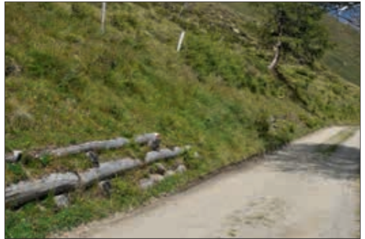
Abb. 9: Eine einwandige Holzkrainerwand zur Sicherung der begrünten Böschung am Almweg nach Oberplanegg, Südtirol, nach 19 Jahren. Fig. 9: Un mur de caisson en bois simple pour la stabilisation d'une pente végétalisée à Almweg après Oberplanegg dans le Tyrol du Sud, 19 ans après.
