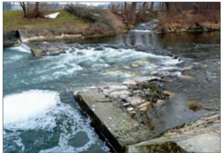
Abb. 5: Töss: Unfallschwelle nach Massnahme. Fig. 5: Töss: accident de seuil après les mesures.
