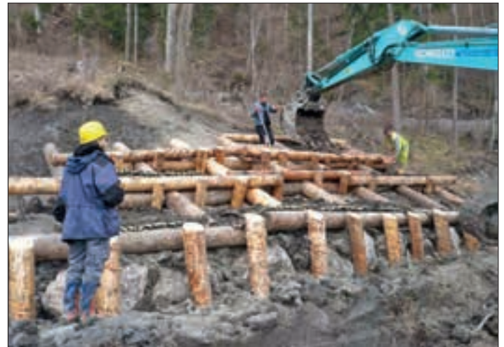
Abb. 7: Lebender Hangrost in der Umsetzung. Eigene Aufnahme. Fig. 7: Treillage vivant mis en œuvre. Propre photographie.
