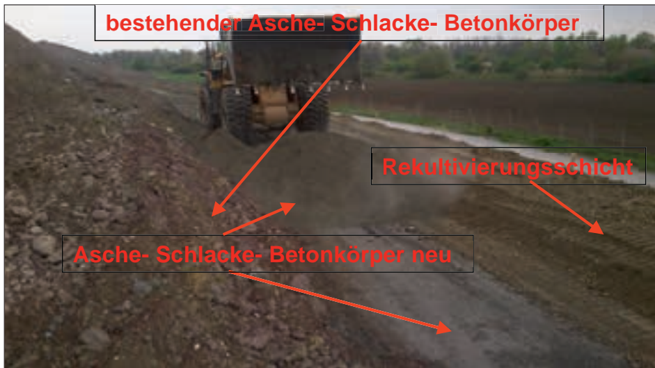
Abb. 7: Einbringen von Rekultivierungsschicht und «Asche-Schlacke-Betonkörper neu» vor den bestehenden Asche-Schlacke-Betonkörper. Fig. 7: Pose de la couche de restauration et «nouveau remblai de cendre, de crasse et de béton» devant le remblai existant.
