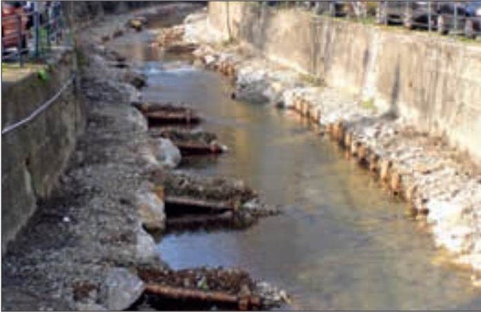
Abb. 17: Strukturierung des neuen Bachbettes mit Faschinenbuhnen als Querwerken und Weidenfaschinen als Längswerken im Bereich Bachgasse, März 2007.
