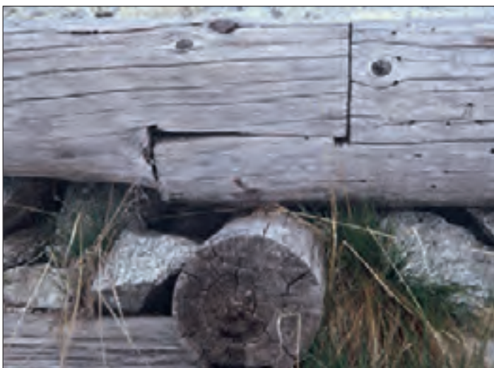
Abb. 5: Die Überblattung zeigt zwar gute handwerkliche Fähigkeiten, durch die hohe Wechsel­feuchtigkeit fault diese Stelle viel schneller. Fig. 5: L'assemblage à recouvrement montre certes de bonnes capacités artisanales, mais pourrait beaucoup plus vite en raison des fortes variations de l'humidité.
