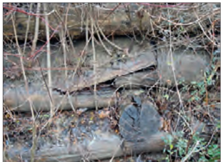
Abb. 6: Das Einschneiden der Rundhölzer bei der Überblattung verursacht eine Schwächung der Holzfestigkeit. Bei starkem vertikalem Erddruck bricht der eingeschnittene Teil. Fig. 6: L'entaille des rondins au niveau de l'assemblage affaiblit la résistance du bois. En cas de fortes poussées verticales du terrain la partie incisée rompt.
