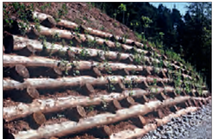
Abb. 21: Die soeben fertig gestellte bepflanzte Holzkrainerwand zur Fussicherung des Rutschhanges, von der Seite gesehen mit der bergseitigen Wegdrainage, Frühjahr 1991.
