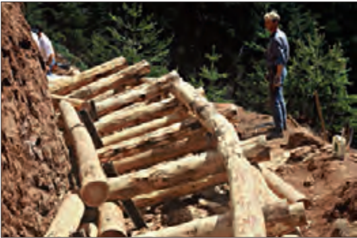
Abb. 18: Abbau der Drahtsteinkörbe und Sicherung des Rutschhanges mit drei bepflanzten Holzkrainerwänden aus Lärchenholz. Die 2. Holzkrainerwand (im Bau), gesichert mit Eisenpiloten, Frühjahr 1991.
