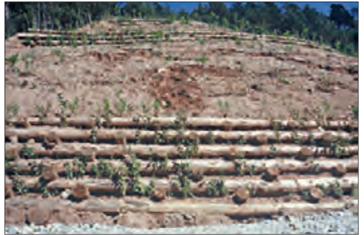
Abb. 19: Unmittelbar nach der Fertigstellung der drei Holzkrainerwände und der Bepflanzung der Zwischenfelder zeigen sich Risse in den oberflächennahen Bodenschichten, die sofort geschlossen wurden, Frühjahr 1991.
