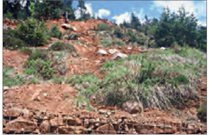
Abb. 17: Rutschhang und Zufahrtsweg zu den Widmayrhöfen über Jenesien, im Bild die kippenden Drahtsteinkörbe am Fuss des Abbruches, Frühjahr 1991.
