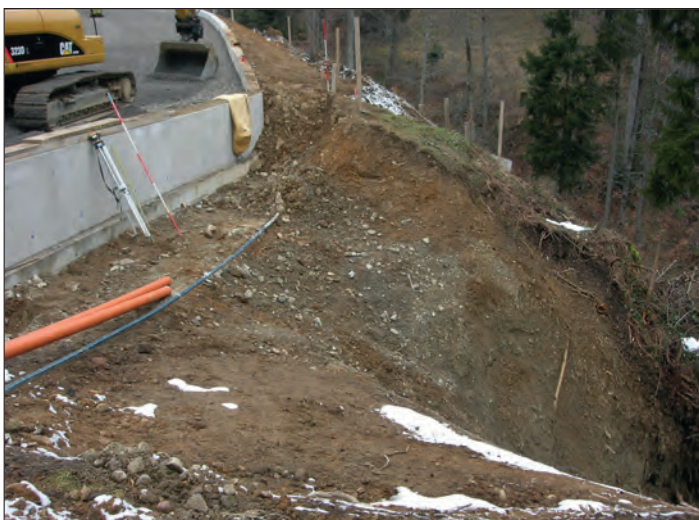
Abbildung 8: Durch rückschreitende Erosion könnte die im Bau befindliche Strasse Schaden nehmen. Figure 8: La route en construction pourrait être endommagée par l'érosion régressive.
