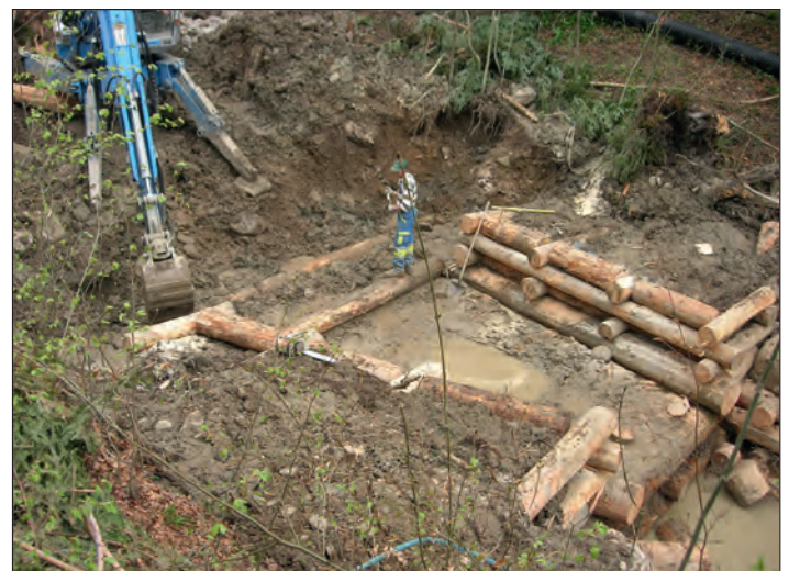
Abbildung 9: Die Sperren wurden als doppelte Holzkasten ausgebildet und die Seitenleitwerke zur Stabilisierung der Böschungen, je nach Verfügbarkeit vor Ort, mit Blöcken oder ebenfalls mit Holzkasten gesichert. Figure 9: Les barrages ont été construits en caissons doubles de bois et les ouvrages latéraux pour la stabilisation des pentes sont consolidés avec des blocs ou aussi avec des caissons en bois en fonction de la disponibilité sur place.
