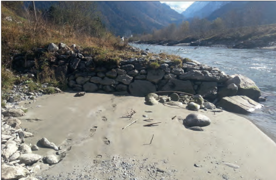
Abbildung 4: Ca. 100 Jahre alte Buhne aus Trockenmauerwerk. Die grosse Herausforderung beim Umbau ist die konstruktive Ausbildung.
