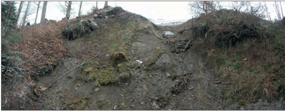
Abbildung 6: Rutschung unten. Figure 6: Glissement de terrain en-dessous.
