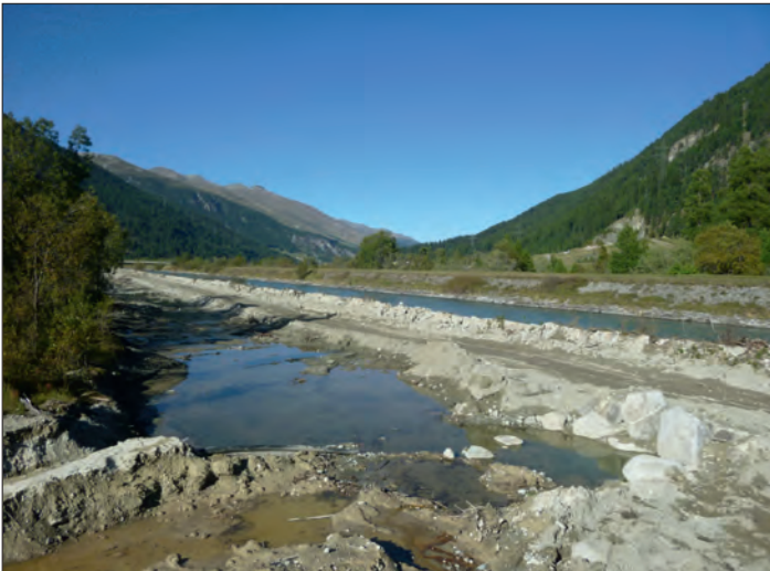
Foto 5: Der Inn bei Bever GR: während der Beseitigung des linksufrigen Damms ... Photo no 5 : L'Inn près de Bever GR : pendant les travaux d'élimination de la digue de la rive gauche ...
