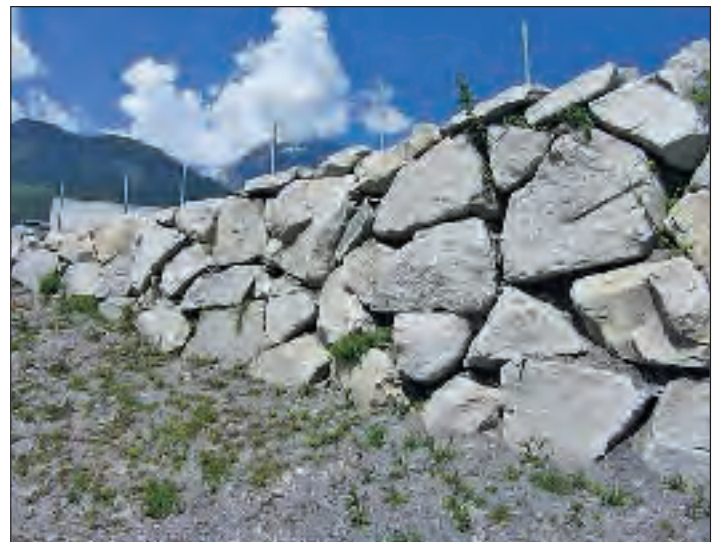
Abb. 7: Trockenmauer, 7. Juni 2013 (Foto: CSD Ingenieure AG). Fig. 7: Mur en pierres sèches, 7 juin 2013 (photo: CSD Ingenieure AG).
