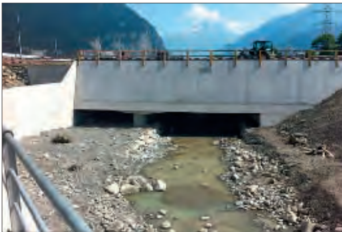
Foto 5: Neuer Durchlass Stille Reuss unter dem Schächenbach.
