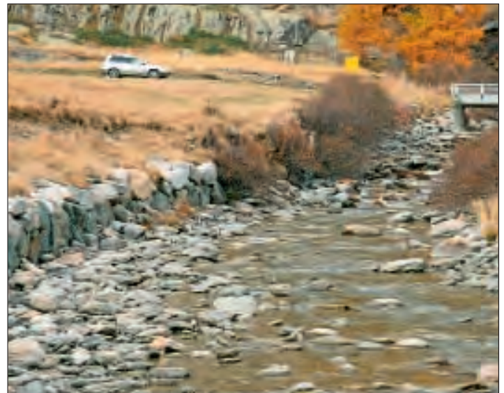
Fig. 2 : La répétition au coup par coup de travaux d'urgence peu réfléchis, après chaque événement occasionnant des dégâts, rompt par mitage la continuité écologique des milieux alluviaux et détériore la qualité écologique et paysagère des cours d'eau (photo P.-A. Frossard, hepia).
