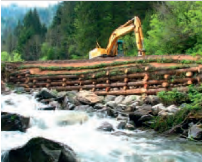
Fig. 5 : Caisson en rondins végétalisé adapté aux contraintes du torrent du Bens, en Isère (photo A. Matringe, ONF).
