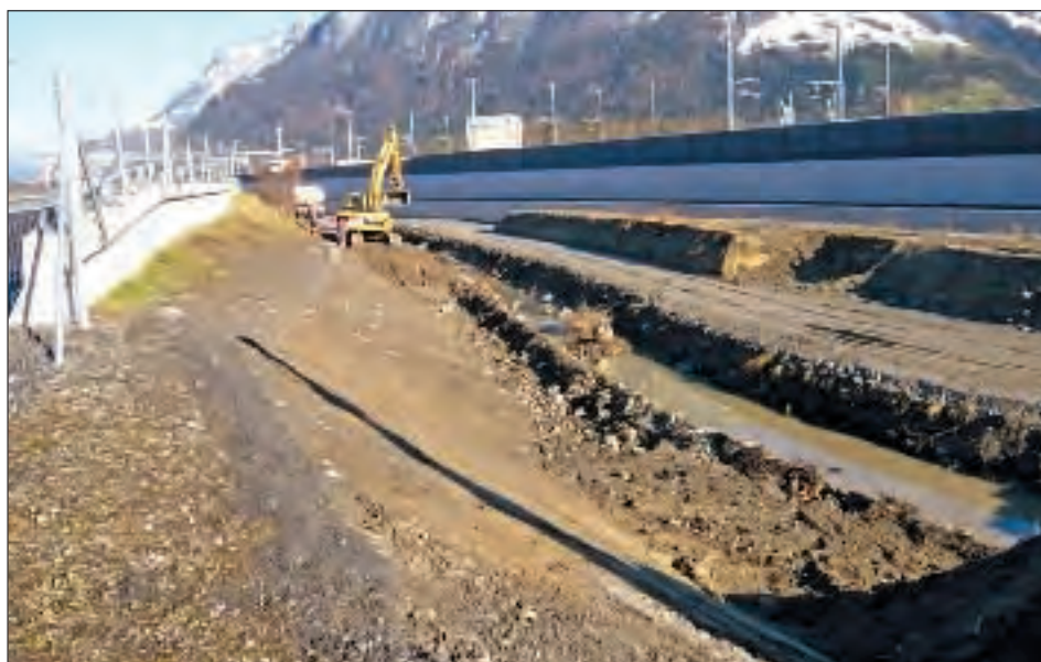
Abb. 2: Der südliche Teil der Baustelle zwischen der Autobahn (links) und der SBB-Linie (rechts). Fig. 2: La partie sud du chantier entre l'autoroute (à gauche) et la ligne CFF (à droite).
