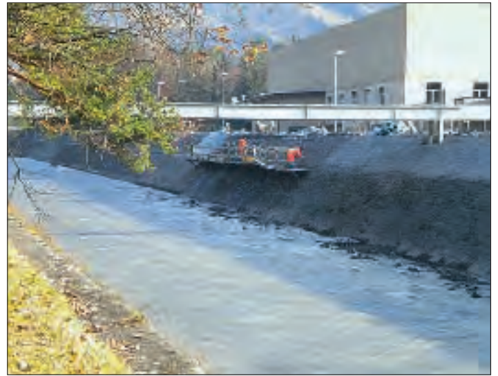
Abb. 5: Gerüst für Dammerhöhungsarbeiten beim Schächen, 28. November 2011 (Foto: CSD Ingenieure AG). Fig. 5: Mise en place pour l'élévation du barrage à Schächen, 28 novembre 2011 (photo: CSD Ingenieure AG).
