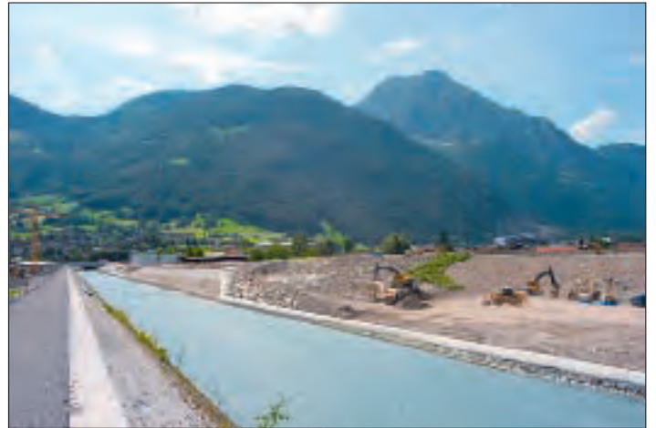
Foto 4: Einlaufbereich in Geschiebesammler RUAG mit abgesenktem HWS-Damm.
