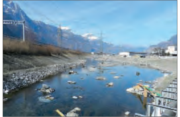
Abb. 7: Renaturierung der verlegten und verlängerten Stillen Reuss südlich der Attinghauserstrasse. Fig. 7: Renaturation de la Stille Reuss déplacée et allongée au sud de l'Attinghauserstrasse.
