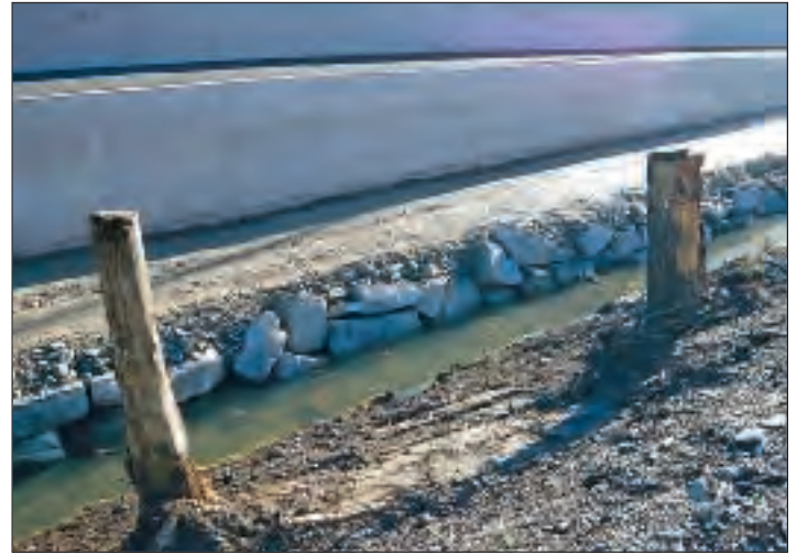
Abb. 4: Die Böschung der Stillen Reuss nach Abtrag Oberboden und Wurzelstöcke des Sommerfliers. Fig. 4: La berge de la Stille Reuss après l'enlèvement de la couche supérieure et des rhizomes de Buddleia.
