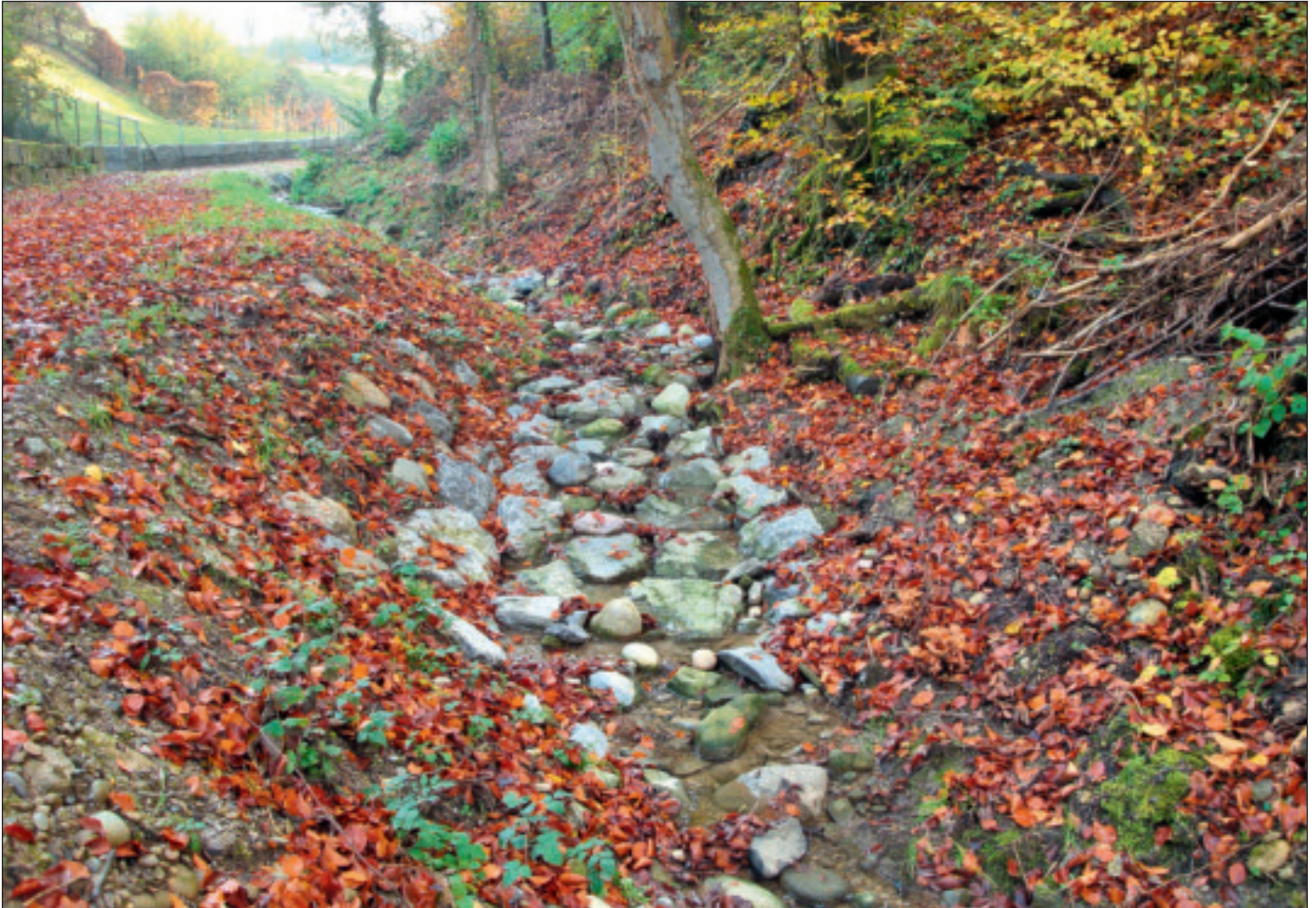
Abb. 5: Seltenbach Freienstein-Teufen ZH: Einsatz von Kalksteinen, kombiniert mit «Grübenköpfen» aus der benachbarten Grube. Figure 5: Seltenbach Freienstein-Teufen ZH: utilisation de pierres calcaires, combinées avec des matériaux venant de la fosse voisine.
