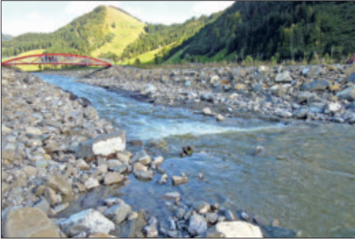
Foto 3: Die Minster nach erfolgter Verbreiterung des Gerinnes mit dem Rähnenverbau. Die Bepflanzung ist noch nicht erfolgt. Photo 3: Le Minster après l'élargissement du lit avec un ouvrage en bordure. La plantation n'a pas encore été effectuée.
