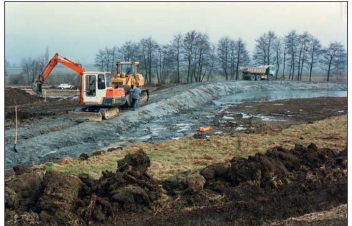
Fig. 7 : Construction de la digue de l'étang pour retenir l'eau provenant des drains détruits en amont (photo Biotec, 1996).
