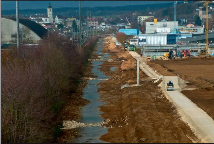
Fig. 4 : Espace mis à disposition de l'Allaine dans un secteur actuellement sans construction mais inscrit en zone industrielle (premier plan). L'emprise à disposition de la rivière et de ses berges est passée de 11 à 25 m (photo Biotec).
