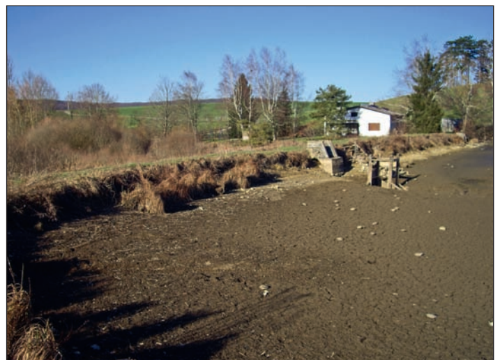
Fig. 4 : Etat très dégradé d'une des digues frontales avec ancien ouvrage de vidange (photo Biotec). Abb. 4: Sicht auf einen stark verfallenen vorderen Deich mit altem Abflussbauwerk (Foto Biotec). Fig. 4: Pessimo stato di una delle dighe anteriori con vecchia opera scarico (foto Biotec).
