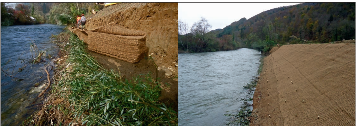
Fig. 11 : Lit de plançons en construction (gauche) et vue de la berge à la fin des travaux (droite) (photos Biotec).
