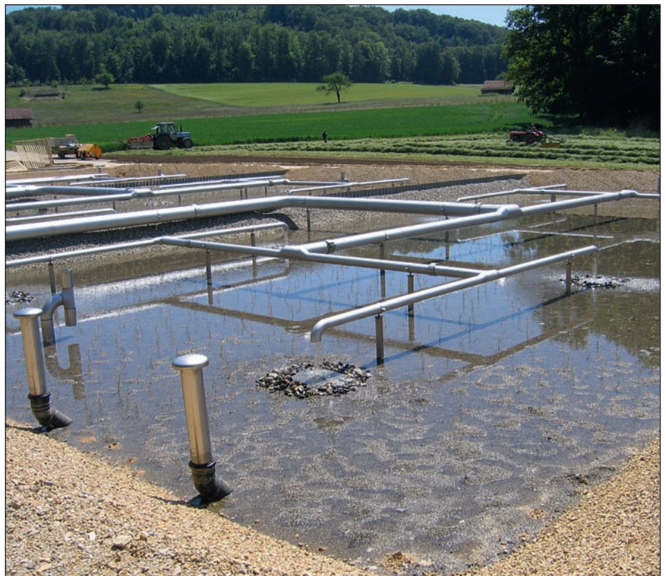
Fig. 3 : 1 er étage de traitement juste après la plantation des roseaux ; on peut y observer l'excellente répartition de l'eau sur l'ensemble du filtre afin que tout le volume du filtre travaille à l'épuration.
