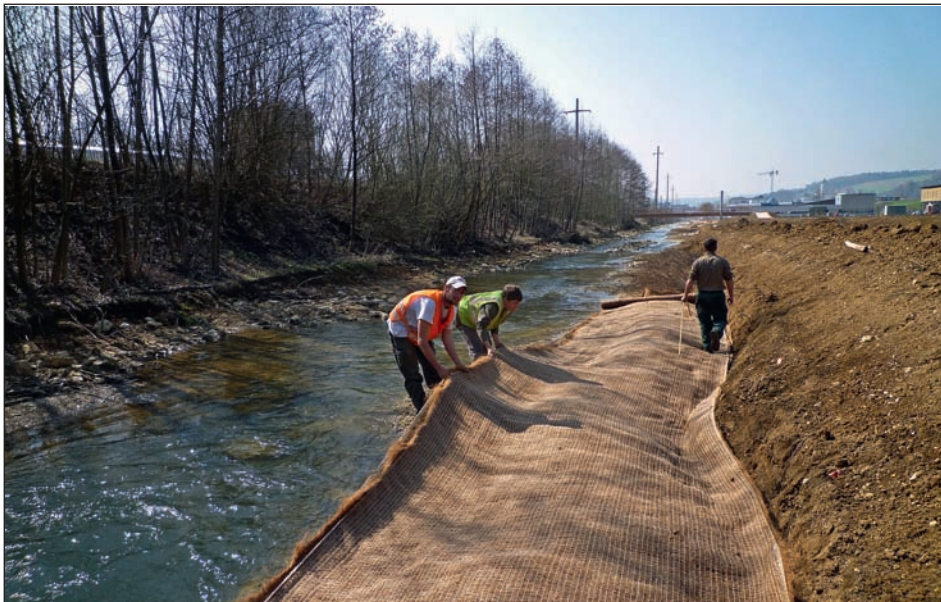
Fig. 10 : Réalisation du « sac » en géotextile biodégradable (coco) formé d'un feutre et d'un filet pour stabiliser le pied de berge à l'arrière des terrasses érodables (photo Biotec).
