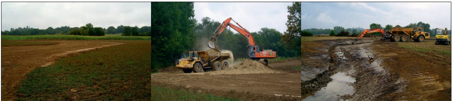
Fig. 5 : Premiers terrassements du nouveau lit. Pour mémoire, la totalité des « déblais » du nouveau lit a été déversée en trois points particuliers du plan d'eau au plus proches des terrassements, pour limiter toute évacuation en décharge et de multiples transports en camion (photos Biotec).
