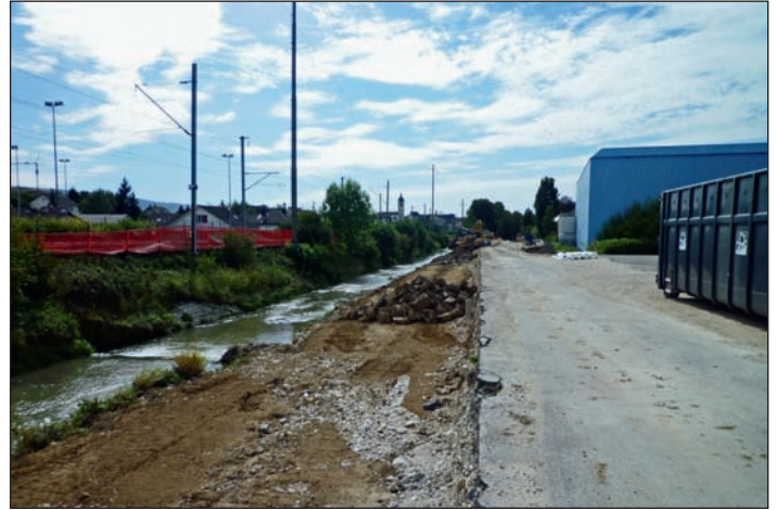
Fig. 5 : Dans le secteur déjà bâti, l'espace redonné au cours d'eau a impliqué la démolition d'une route, la redéfinition des circulations dans la zone industrielle et le déplacement d'une batterie de câbles électriques de très haut voltage (photo Biotec).
