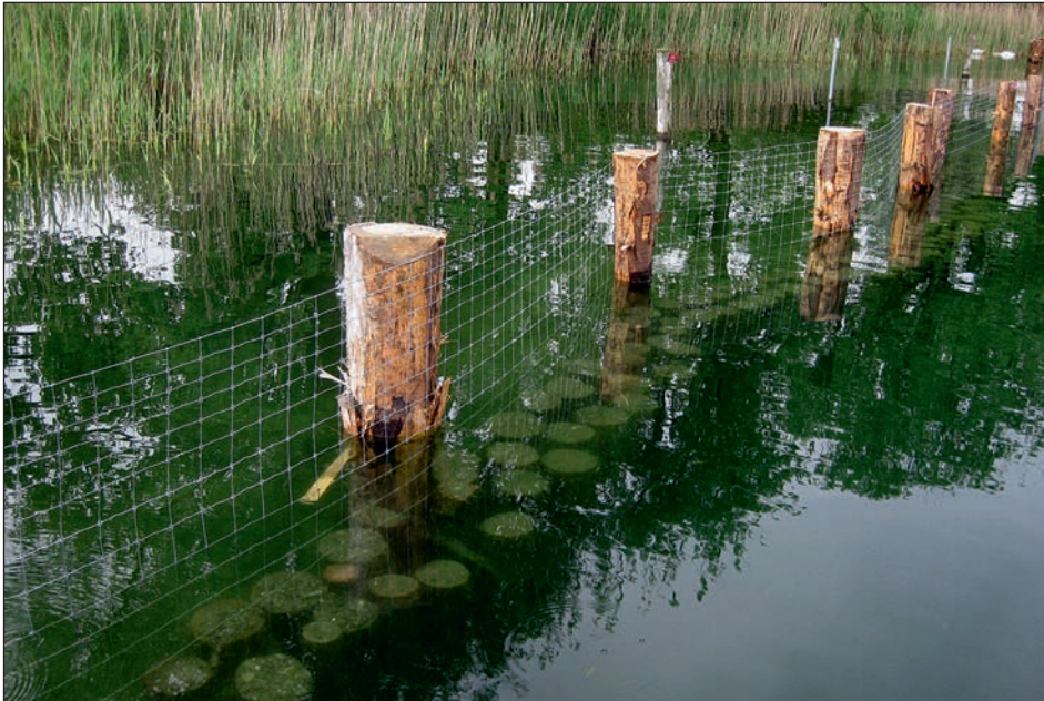
Abb. 6: Kliffkantenschutz mit doppelreihiger Holzpalisade, Kieshinterfüllung und Schilfschutzzaun, Dersbach 2010.
