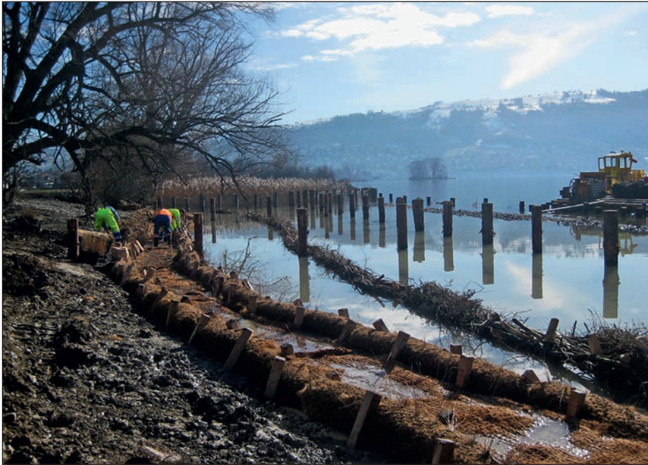
Abb. 5: Initialbegrünung der Uferlinie mit vorkultivierten Vegetationsmatten und -walzen. Vorgelagerte Totholzfascine als Sedimentfang. Pfähle für Schilfschutzzäunung inkl. Querschläge.
